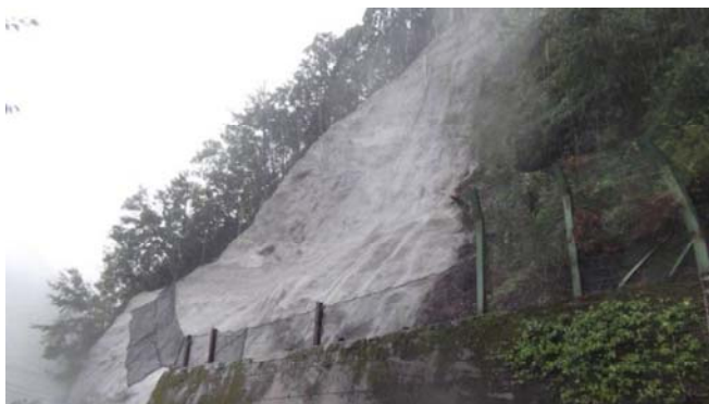
写真 3 上北山村白川地区崩壊地を望む
